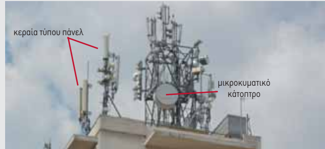
Σχήμα 3: Κεραιές από τις οποίες αποτελείται ένας χαρακτηριστικός σταθμός βάσης
